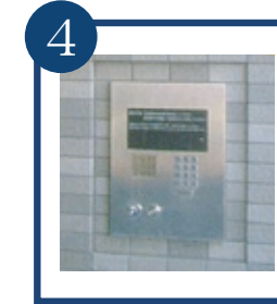
オートロックシステム
