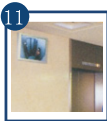
E V内防犯カメラモニター
