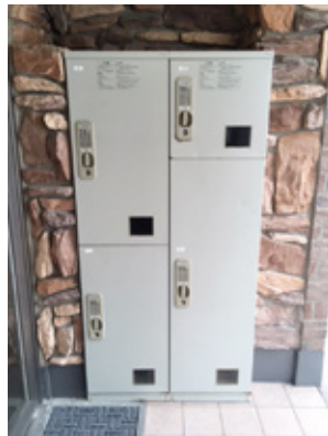
宅配ボックス
